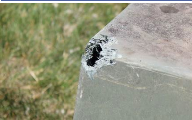
Dégâts sur boîtier
