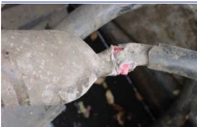
Câble endommagé et avec une fuite
