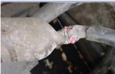
Cable dañado y con fugas
