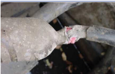
Beschädigtes, undichtes Kabel
